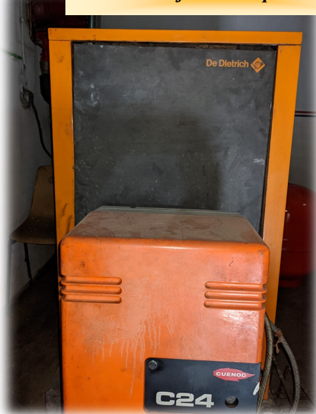
Chaudière à fuel à remplacer
